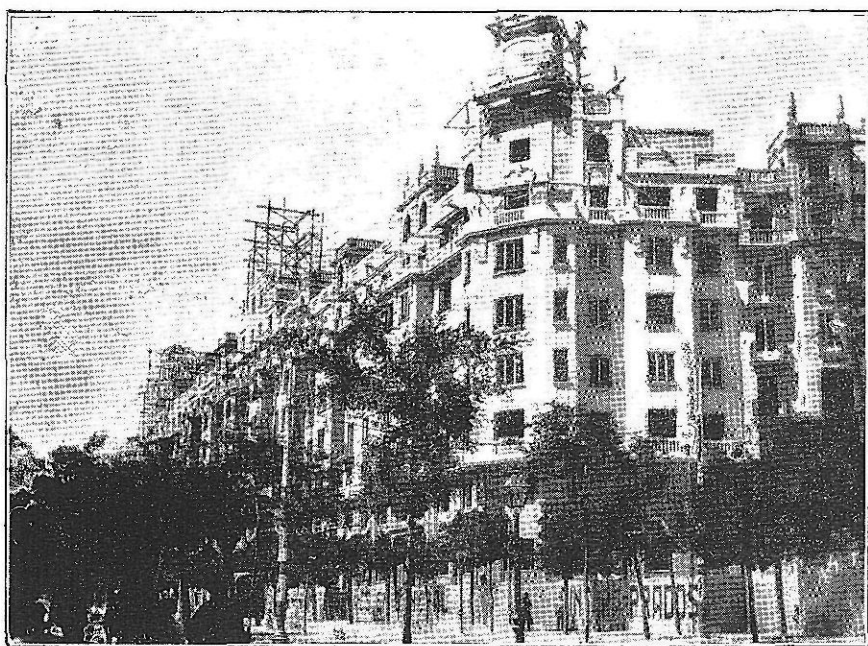
Fot. 12.—Construcción de tres casas del tipo A y cinco del tipo B en la calle de Santa Engracia. Esquina de la calle de María de Guzmán. Estado de las obras en 1.º de julio de 1929.
